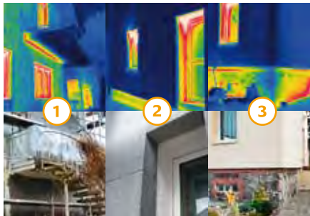
Abb. 56: Foto- und Thermographieaufnahmen von massiven Wärmebrücken bei einer Gebäudesanierung: dämmstoffdurchstoßende Balkonplatte (1); ungedämmte Fenster- und Türschwelle (2); ungedämmter Sockel aus Bruchsteinmauerwerk (3).
