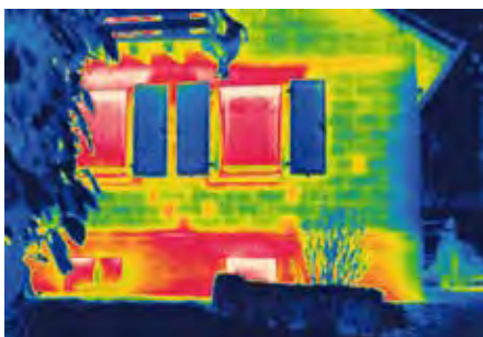
Abb. 19: Auf dem Thermogramm der Fassade sind Stellen im Mauerwerk zu erkennen, die einen erhöhten Wärmeabfluss aufweisen. Hier wurden mit Mörtel und Steinbruchstücken Mauerwerkslücken gefüllt. Diese Fehlstellen haben eine höhere Wärmeleitfähigkeit als das übrige Mauerwerk.
