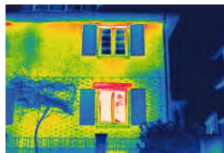
Abb. 9: Erhöhter Wärmeabfluss im Bereich des Fenstersturzes durch Thermographie sichtbar gemacht.
